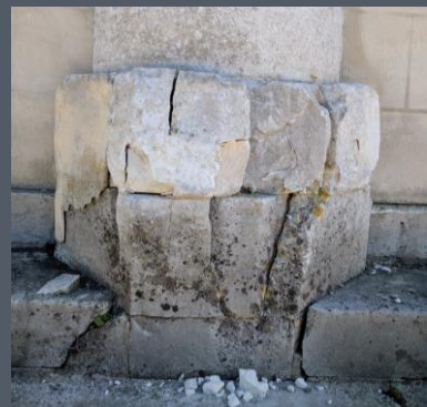
L'extrémité du bâtiment, bien fragilisée.
